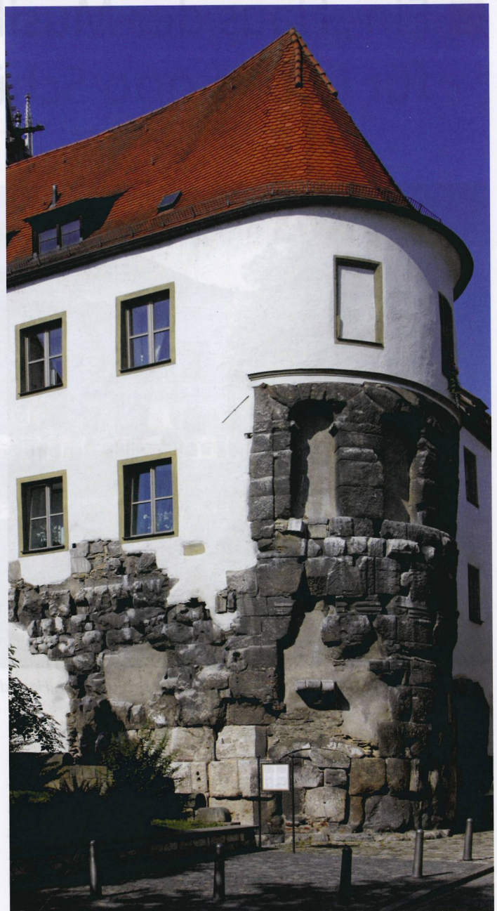
Die Porta Praetoria. Vom einstigen Nordtor der römischen Befestigungsanlagen ist ein Durchgangsbogen (von ursprünglich zwei) und ein Turm (von ursprünglich ebenfalls zwei) erhalten. Die Anlage soll in den nächsten Jahren grundlegend saniert werden.
